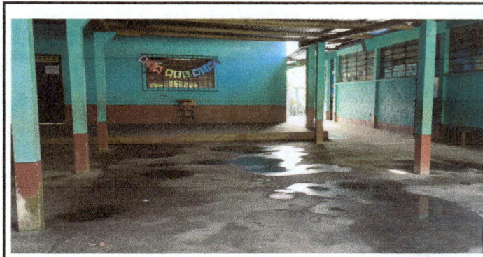
Foto 10: Paredes exteriores con pintura dañada.
