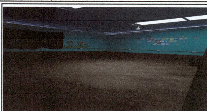
Foto 8: Torta de piso de concreto en aula 6 del módulo 2 que necesita ser sustituida por piso cerámico
