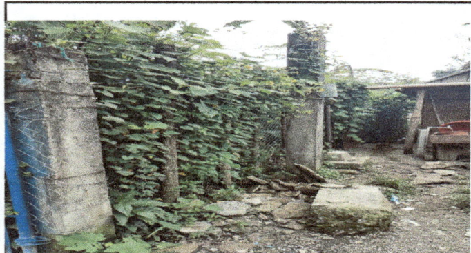
Foto 9: Muro perimetral en malas condiciones.
